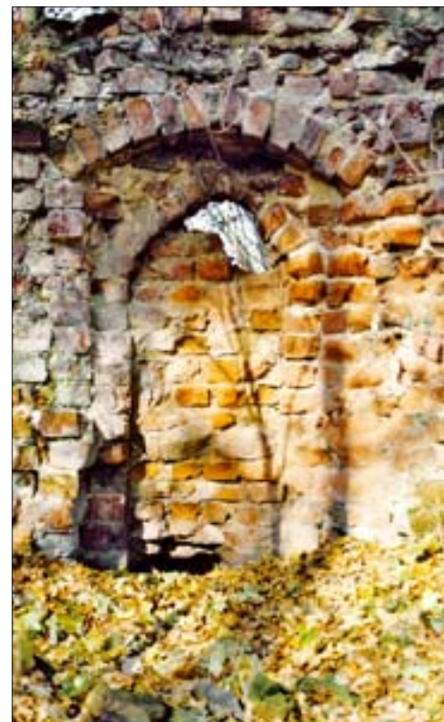
17. Zamurowana furta do przedmurza w skrzydle północnym, widok w kierunku północnym. Fot. autorka, 2004 r.
