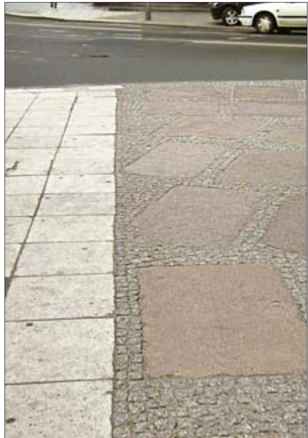
25. Szczecin, pl. Grunwaldzki/ul. Piłsudskiego, nawierzchnia współczesna, wykonana z użyciem materiału zabytkowego, miejsce styku z nawierzchnią współczesną wykonaną z betonowych płytek chodnikowych, stan z 2004 r.
