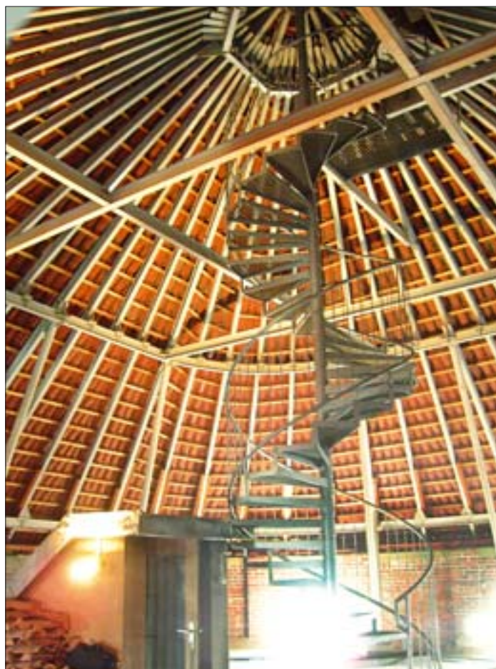
28. Stalowa konstrukcja dachu na baszcie Senatorskiej (Lubrance). Fot. P. Stępień. 28. Steel roof construction of the Senators Tower (Lubranka). Photo: P. Stępień.
