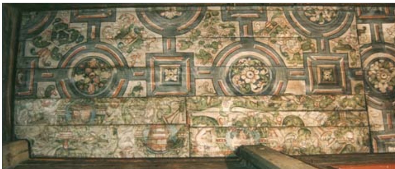
19. Południowa część stropu nawy południowej z wtórnie umieszczonymi w nich deskami z pierwotnego parapetu chóru muzycznego. Fot. R. Stasiuk. 19. Southern part of the southern nave ceiling with replaced boards from the original parapet of the music choir. Photo: R. Stasiuk.
