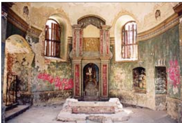
2. Narol. Nieużytkowana i zdewastowana cerkiew. Fot. P. Rydzewski. 2. Narol. Unused and devastated Eastern rite church. Photo: P. Rydzewski.
