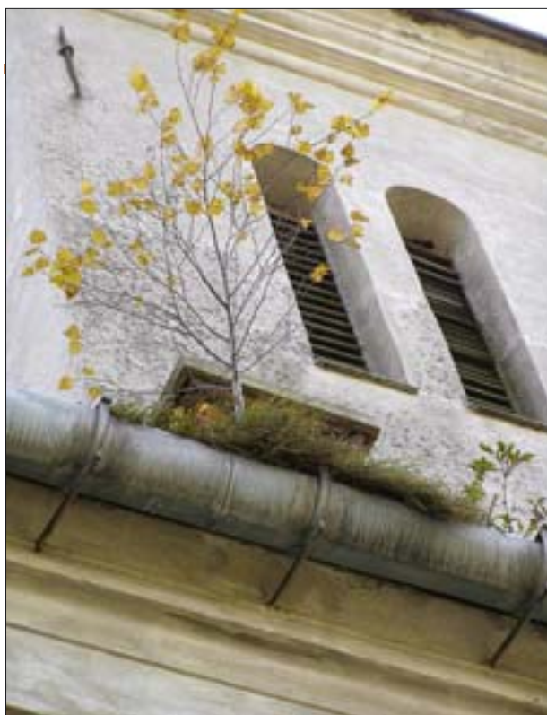
11. Krzynowłoga Mała. Nieczyszczone ryny i rury spustowe są niejednokrotnie przyczyną braku odpływu wód opadowych, a co za tym idzie – zamoknięcia ścian budynku. Fot. S. Cegłowski.
