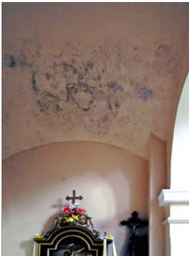
14. Wieczfnia Kościelna. Sklepienie kościoła pw. św. Stanisława Biskupa, widoczne efekty zawilgocenia. Fot. S. Cegłowski.
