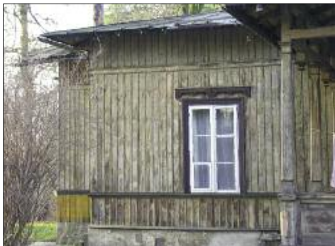
2. Otwock-Świder, ul. Kollątaja 92, willa Wedla, 1903 r. Fragment elewacji południowej z szalunkiem w układzie pionowym ozdobionym listwami o profilu simowym maskującymi styki desek, 2008 r.
