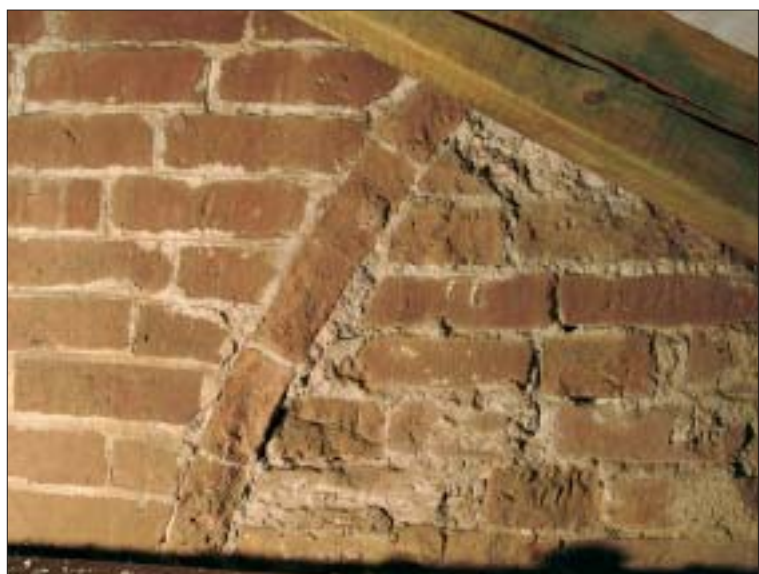
7. Łuk nadportalny widoczny w przestrzeni poddasza kruchty. 7. Arch over a portal seen in the space of the porch attic.
