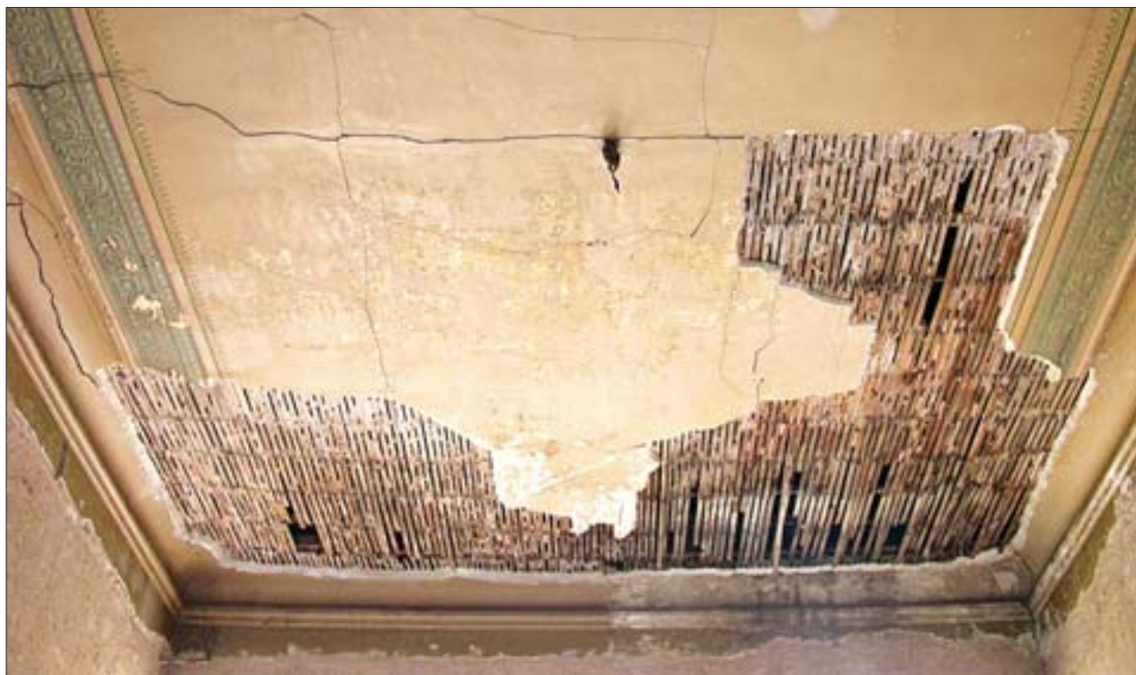
11. Jedno z pomieszczeń po zdjęciu odpadających fragmentów dekoracji sufitu i po usunięciu „konstrukcji zabezpieczającej”. Od drewnianej konstrukcji stropu odpadło ok. 25 proc. tynków. Część z nich udało się zabezpieczyć, część uległa zniszczeniu. Spośród 32 uratowanych fragmentów dwa miały znaczną powierzchnię (ok. 1 m 2 ). Jeden z ich oprócz polichromii miał również dekorację sztukatorską.
