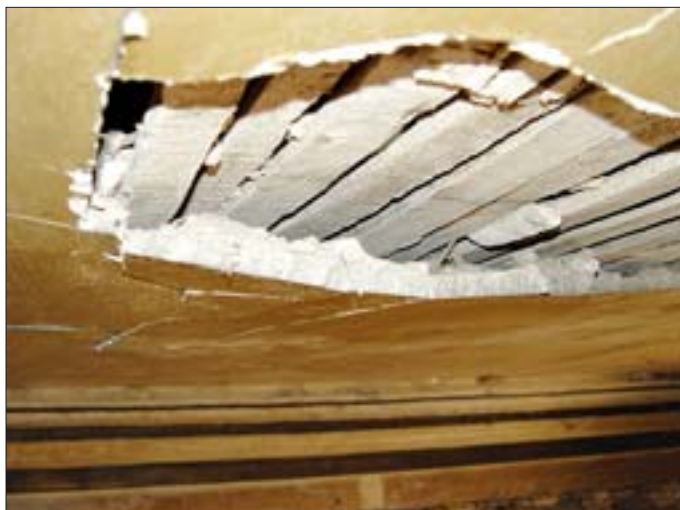
8. Fragment sufitu w holu głównym. Widoczny ubytek oraz odspojenie tynku w formie „kieszoni”. Na takich niepolichromowanych fragmentach testowano metody, wykorzystane później do podklejania cenniejszych fragmentów dekoracji malarskiej i sztukatorskiej. 8. Fragment of the ceiling in the main hall. Visible gap and loosening of the plaster in the form of a “pocket”. Such non-polychrome fragments were used for testing methods applied later for gluing the more valuable fragments of the painted and stucco decoration.
