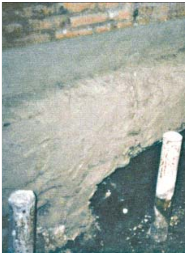
10. Wzmocnienie fundamentów pałacu za pomocą mikropali. 10. Reinforcement of Palace foundations with the help of micro-posts.
