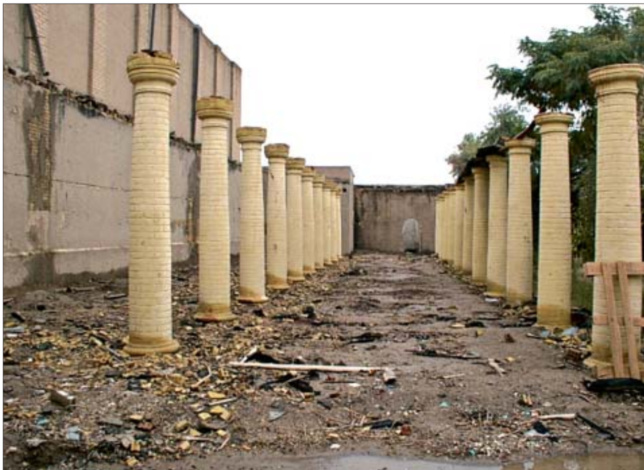
3. Patio teatru hellenistycznego. Zniszczenia pod wpływem czynników atmosferycznych. 3. Patio of a Hellenistic theatre. Damage caused under the impact of atmospheric factors.
