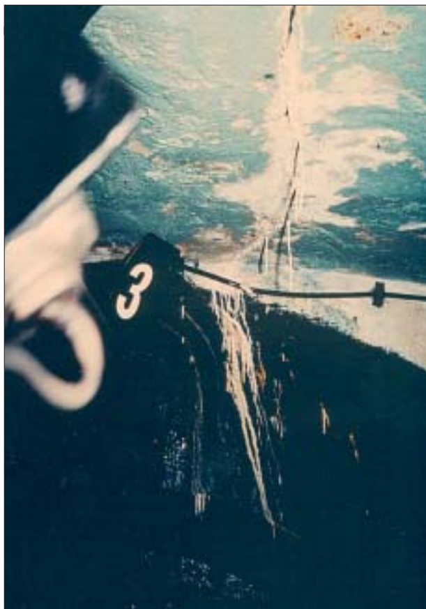
9. Fragment stropu galerii wewnątrz korpusu elektrowni wodnej. Widoczne pęknięcia i nacieki.
