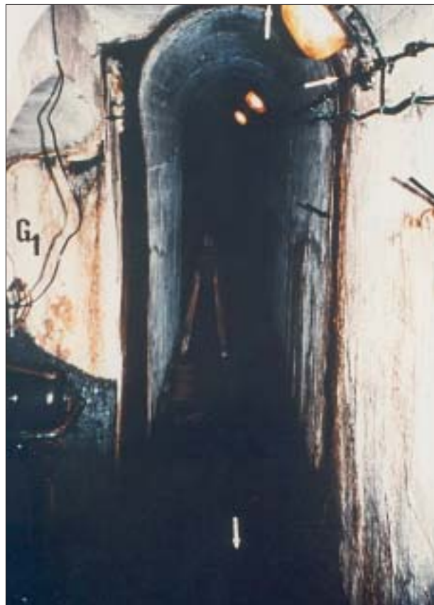
5. Widok galerii wewnątrz korpusu elektrowni wodnej, fragment wlotu do turbiny wodnej. Widoczne spękania i wycieki wody.
