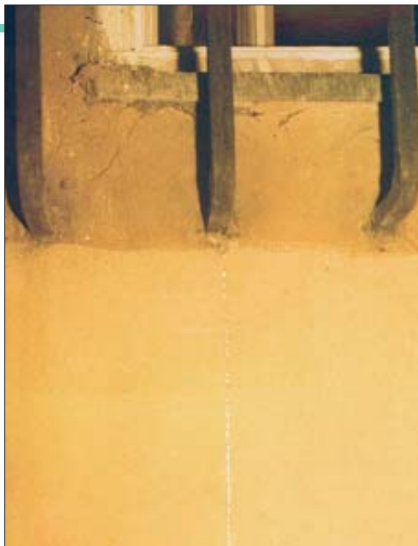
3. Fragment okna pomieszczenia poddanego renowacji w budynku przy ul. Brzozowej 31/33 w Warszawie od strony ul. Kamienne Schodki. Widoczny wyciek materiału iniekcyjnego w miejscu dolnego zakotwiczenia w murze środkowego pręta kraty.
