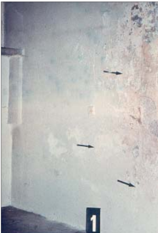
1. Zakres korozji ściany w pomieszczeniu, budynek przy ul. Brzozowej 31/33 w Warszawie, przed renowacją. Wszystkie fot. autor.
