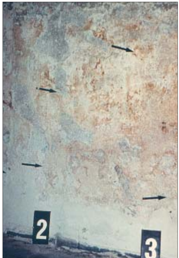
2. Korozja mechaniczna i biologiczna ściany w pomieszczeniu budynku przy ul. Brzozowej 31/33 w Warszawie, przed renowacją.
