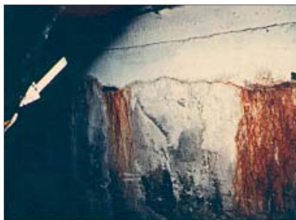
8. Widok ściany galerii wewnątrz korpusu elektrowni wodnej. Widoczne spękania i wycieki wody.
