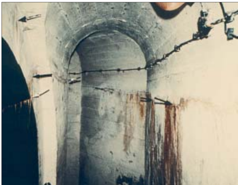
7. Widok galerii wewnątrz korpusu elektrowni wodnej, fragment wlotu do turbiny wodnej. Widoczne spękania i wycieki wody.
