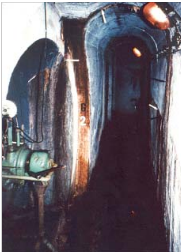
4. Widok galerii wewnątrz korpusu elektrowni wodnej. Widoczne spękania i wycieki wody na ścianach bocznych i stropie, woda na posadzce.
